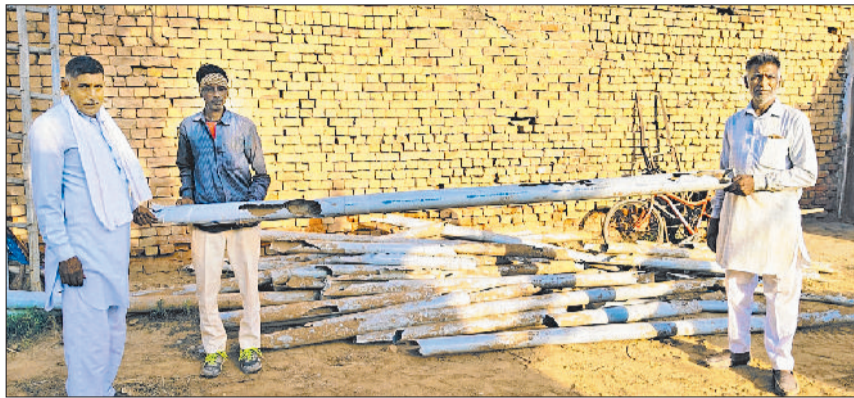
भूना। भूना-उकलाना सड़क निर्माण के दौरान टूटी पानी की पाइपलाइन दिखाते प्रजापति बस्ती के लोग
